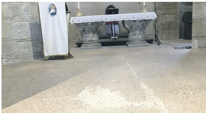
LA STRUTTURA In alto la chiesa di Santa Sofia: sopra una delle parti ammalorate oggetto dei lavori
