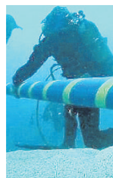
Impianto di cavi sottomarini
