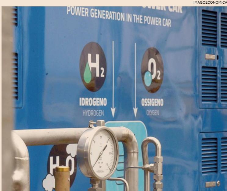
Idrogeno. Il nodo costi elevati grava sul mercato italiano
